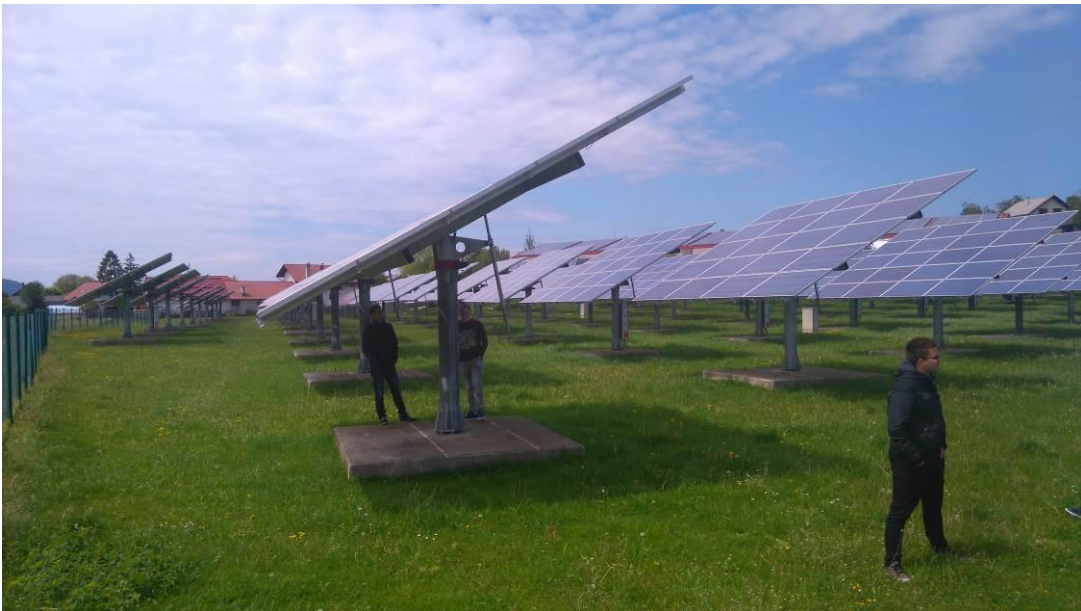
Slika 12: Oglad fotonapetostnih sledilnih sistemov na terenu
